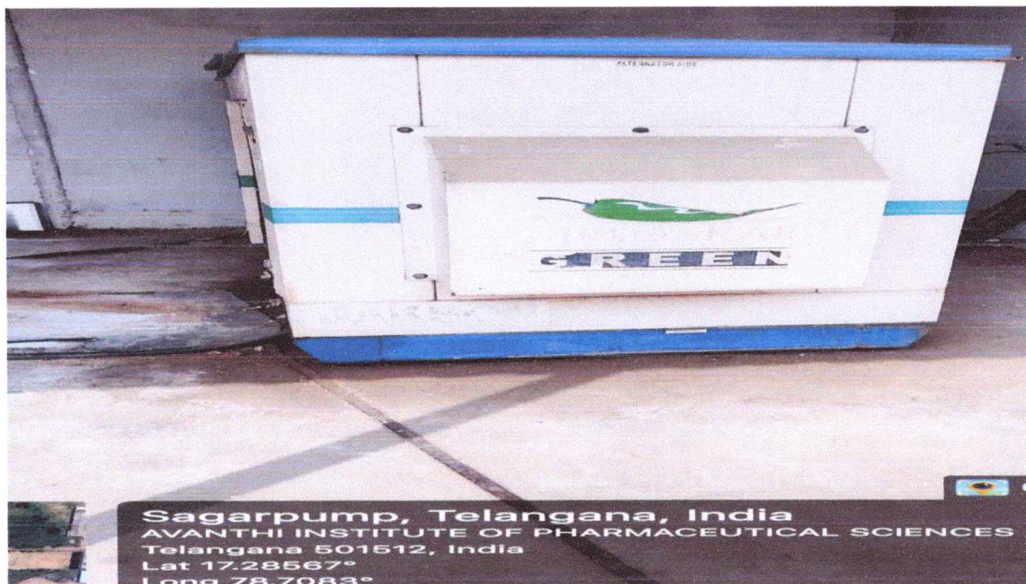
FIG: 7 DG-SET 62.5KV
