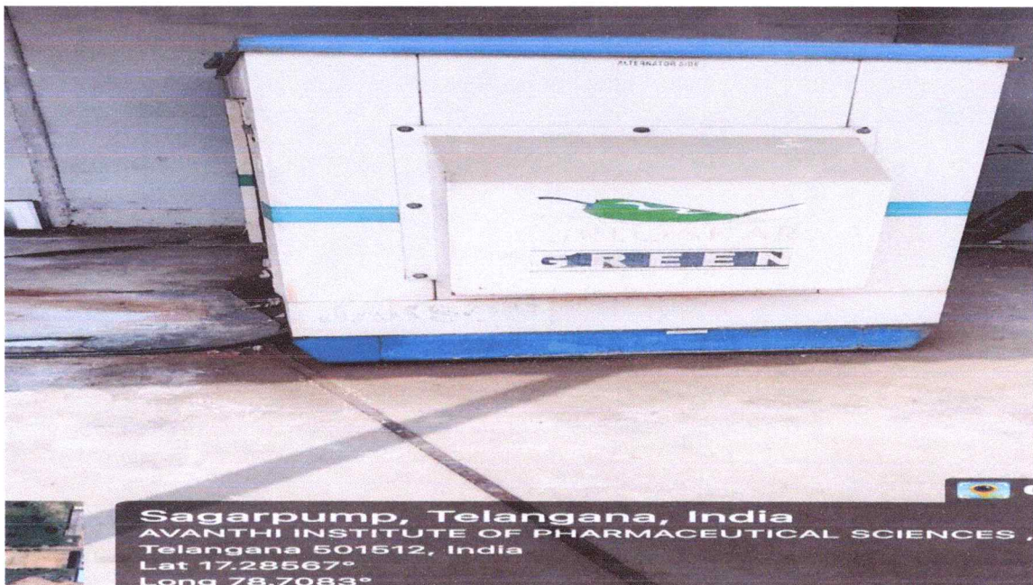
FIG: 7 DG-SET 62.5KV
