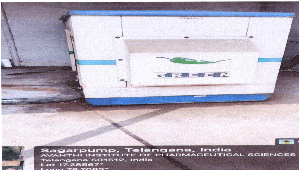
FIG: 7 DG-SET 62.5KV
