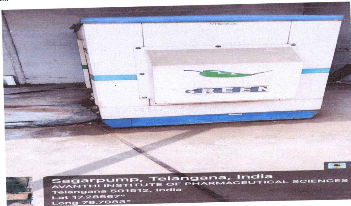
FIG: 7 DG-SET 62.5KV
